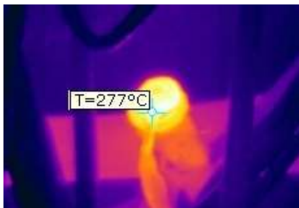
Рисунок 22. Пример обнаружения пожароопасного разогрева болтового контактного соединения
